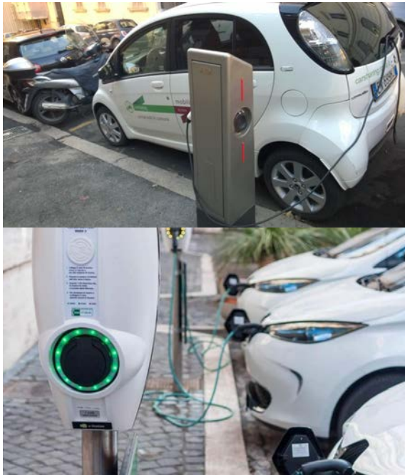
Σχήματα 6.36 & 6.37 Υποδομές φόρτισης ηλεκτρικών οχημάτων
