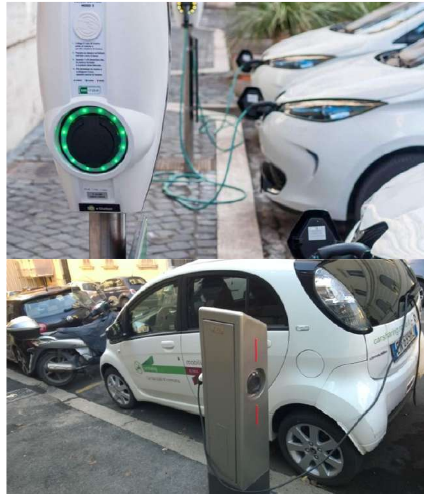
Σχήμα 9.35 Σταθμοί φόρτισης ηλεκτρικών οχημάτων παρά την οδό
